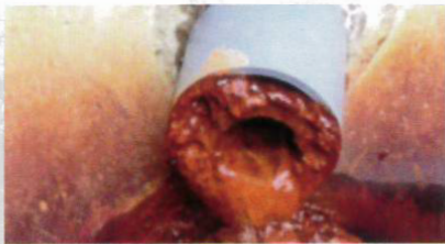
酸化鉄細菌により目詰まりした樹脂製有孔管
